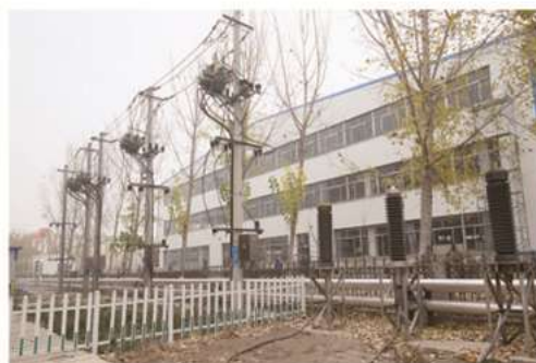
配电网真型模拟系统
