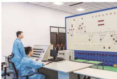
有源配电网静态模拟实验室
